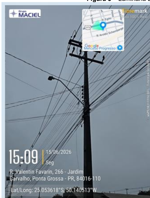
Figura 3 – Luminária LED Instalada em Via Secundária (V3 ou V4)
